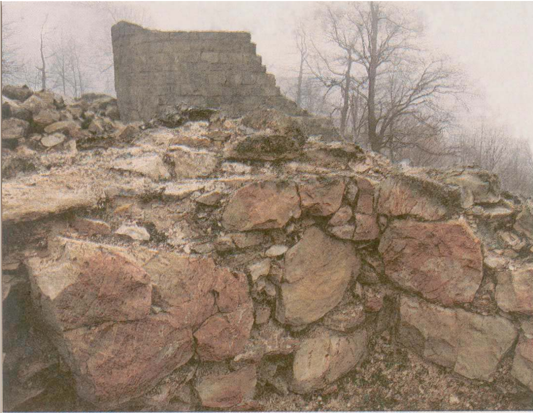
Einsam und verlassen: der teilweise verfallene Bergfried der Falkenburg in diesen Tagen. Ab Mai soll er zur Aussichtsplattform umgestaltet werden.
