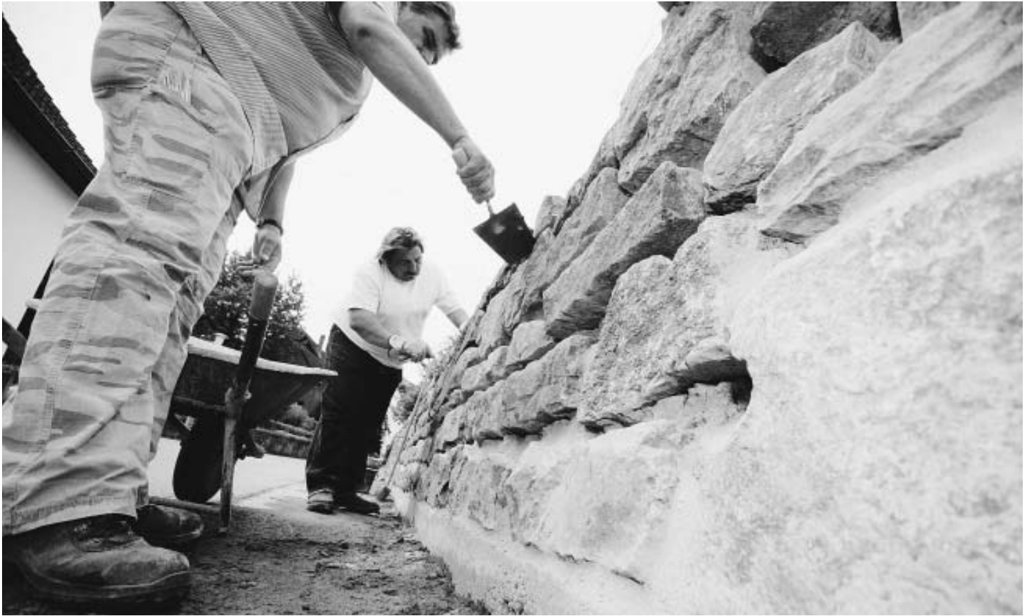
Feinschliff: Matthias Barton (vorn) hat mit seiner Truppe die Bruchsteinmauer entlang der Habichtsberger Straße fast fertig.
