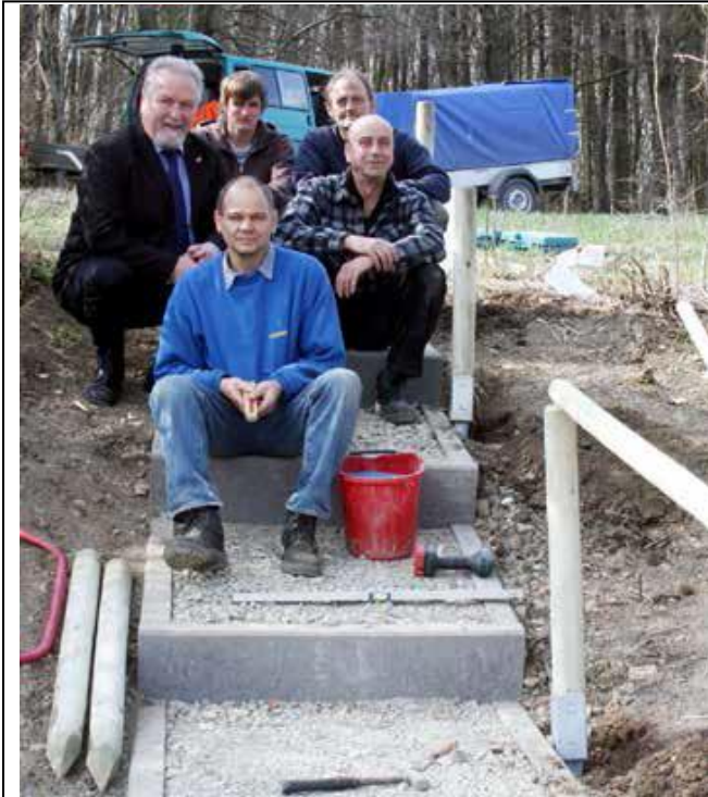
Ein lang gehegter Wunsch der Extertaler Wanderfreunde ging jetzt in Erfüllung: Der marode Aufstieg zur Hohe Asch wurde jetzt durch die Mitarbeiter der EUWATEC saniert.
