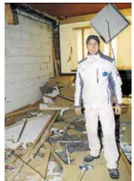
Epifanio Di Fede steht in einem Raum jenseits des Bistros, der sehr renovierungsbedürftig ist
