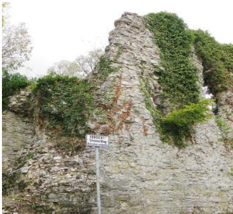
Muss saniert werden: Der Wehrturm soll zu Untersuchungszwecken demnächst eingestüst werden.
